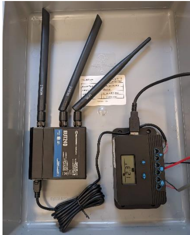
Figure 9 : Contrôleur solaire et modem cellulaire
